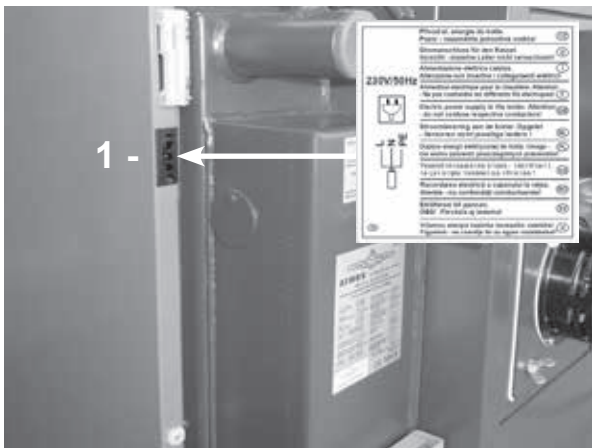
Connettori sulla caldaia LATO DESTRO
